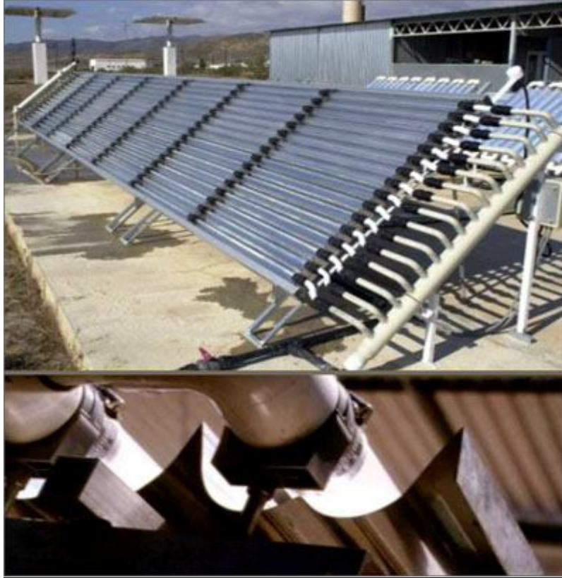
Figure I. 10: Pilote solaire utilisant des suspensions installées sur la plate forme d'Almería en Espagne 16 .
