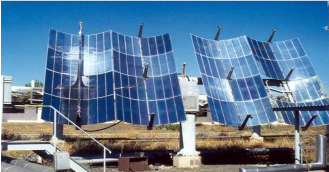
Figure I. 9: concentrateur en auge parabolique doté d'un système de suivie du soleil à deux axes, installé sur la plate forme solaire d'Almería en Espagne 2 .
