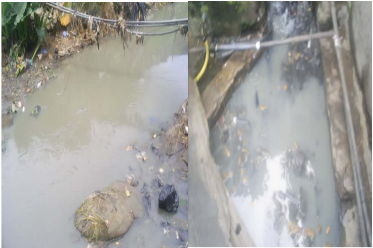
Figure II.4: Eau de ruissellement et tuyaux du réseau de distribution d'eau à ciel ouvert en contact avec l'eau usée et les déchets humains à Bolibana
