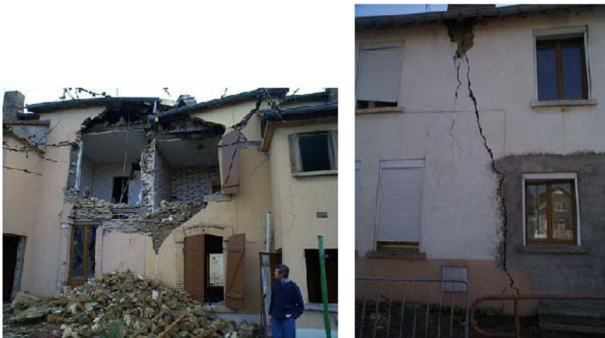
Photo 2 : Effets de compression (gauche) et d'extension (droite) sur les bâtiments
