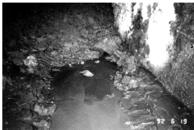
Figure 10. Inondation du tunnel de Wushantou, Japon 1992, (Wanget et al., 2002)
