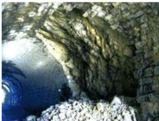
Figure 59. Rupture partielle : La moitié de la voûte est tombée par écrasement du piédroit (CETu, 2004)
