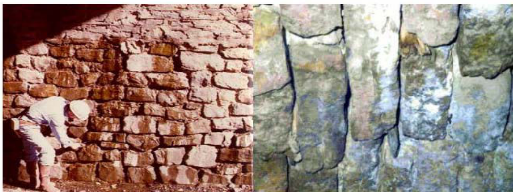
Figure 49. Déjoiement du piedroit, déjoiement de la voûte, (CETu, 2004)
