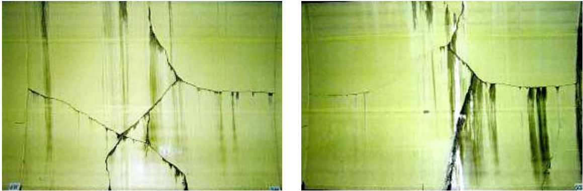
Figure 7. Tunnel de A38 Saltash (R.U, 1997), fissurations sur les parois (Sauer, 2004)
