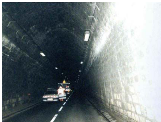
Figure 57. Méplat dans un tunnel routier (CETu, 2004)
