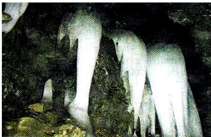
Figure 9. Arrivée d'eau gelée dans le tunnel de Galibier, (Mercusot et al , 1999)
