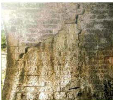
Figure 56. Fissure transversale couplée à une fissure oblique (CETu, 2004)
