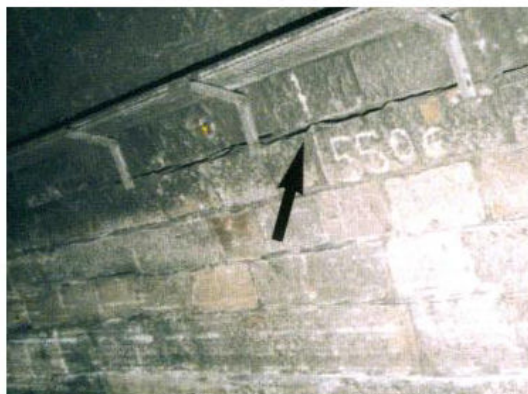
Figure 55. Fissure longitudinale, le mortier est toujours présent sur une lèvre de la fissure (CETu, 2004)
