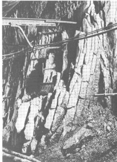
Figure 2.2 - Ecaillage en parements du tunnel du Mont-Blanc (Panet, 1969)
