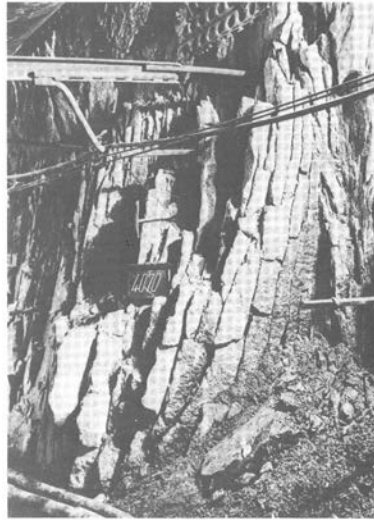
Figure 2.2 - Ecaillage en parements du tunnel du Mont-Blanc (Panet, 1969)
