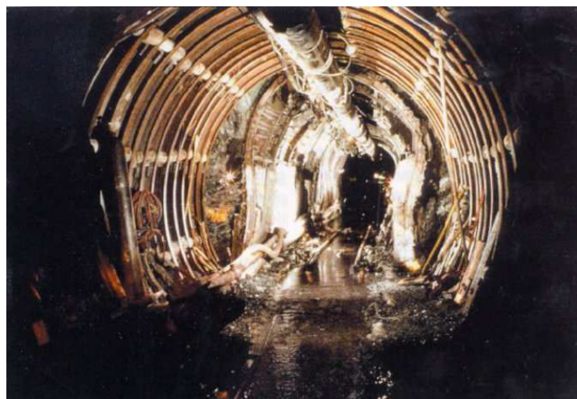
Figure 2.5 - « Squeezing » dans le tunnel de base du Gotthard (Laigle, 2004)
