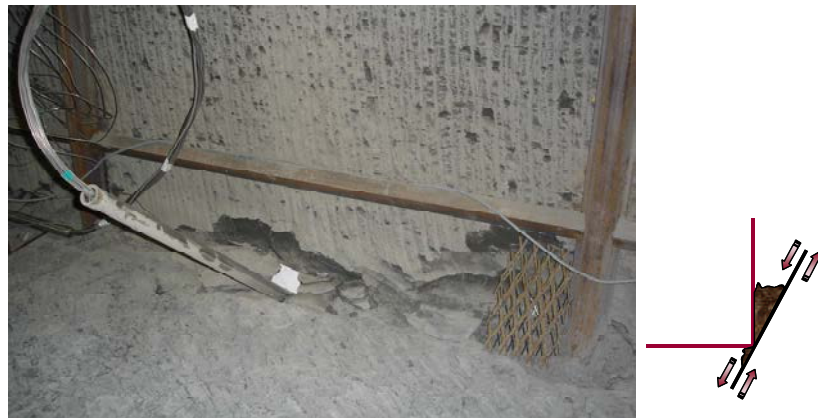
Figure 7.40 - Fracturation observée dans la galerie de Tournemire
