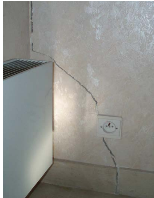
Figure I.1. Désordres de la structure au cours des périodes de sécheresse (Région bordelaise)
