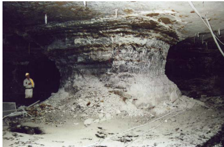
Figure 3.2. Ecaillage des piliers constaté lors d'une visite sur le site d'étude
