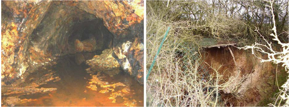
Figure 1.15. Blocs tombés en galerie (a), et Effondrement de la descenderie de la Boissière (13/07/2000) (b)
