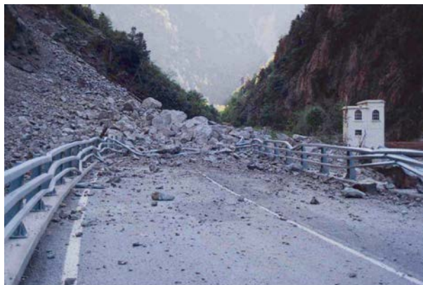
Figure 2.1. Eboulement rocheux dans la vallée de la Tinée
