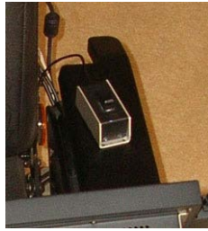
FIG. 3.1: Détail du capteur TOR utilisé lors des tests.
