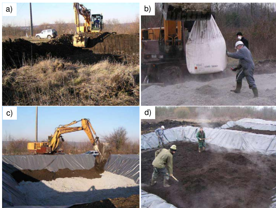
Figure 9 : Mise en place du dispositif pilote de construction de sol en parcelles lysimétriques a) terrassement des bassins ; b) mélange des matériaux parents ; c) et d) mise en place des couches
