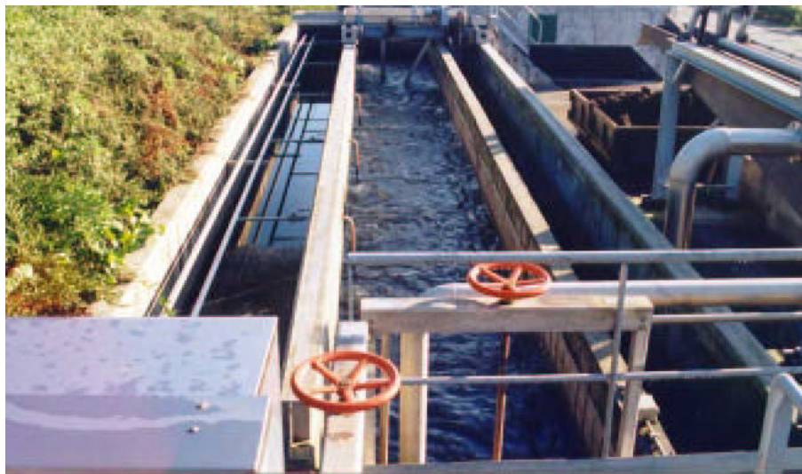
FIG. A.5 – Unité de desablage
