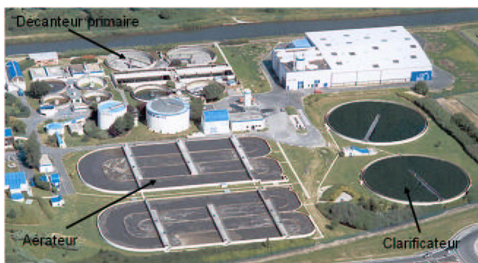
FIG. A.2 – Vue d'ensemble d'une station d'épuration (Douai)
