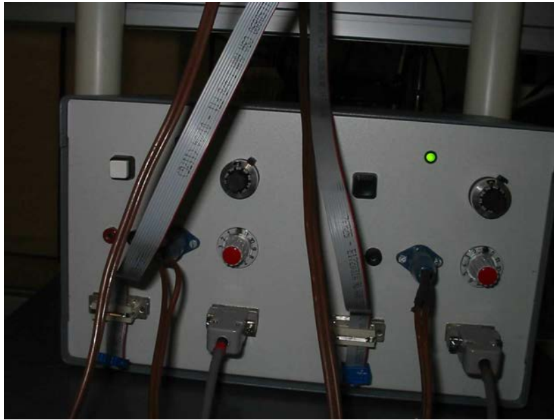
Fig. 7.5 – Boîtier de commande des moteurs réalisé par l' atelier électronique du LEMTA . On dispose de deux tableaux de commande sur la façade, commandant séparément les deux moteurs. Le petit bouton carré blanc (ou noir) permet la mise sous tension du système, validée visuellement par la petite diode de couleur verte. À sa droite, un potentiomètre pour imposer manuellement la vitesse du moteur correspondant. En dessous, un bouton multi-positions pour passer de la commande manuelle (position 1) au pilotage par ordinateur (position 3) par une position intermédiaire neutre 2. À gauche de ce bouton, nous avons la possibilité de lire les tensions de sortie des cartes d'asservissement proportionnelles à la vitesse de rotation du plateau correspondant. La fiche en bas à gauche permet de relier le codeur à la carte d'acquisition. Le dernier bouton en bas à droite relie la carte d'asservissement correspondante au PC. Enfin, les deux fiches bleues permettent d'alimenter les moteurs.
