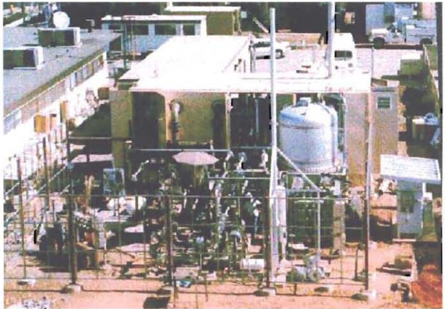
Photo 3. Centrale utilisant une pile MCFC installée par M-C Power à San Diego, en Californie, en 1997.
