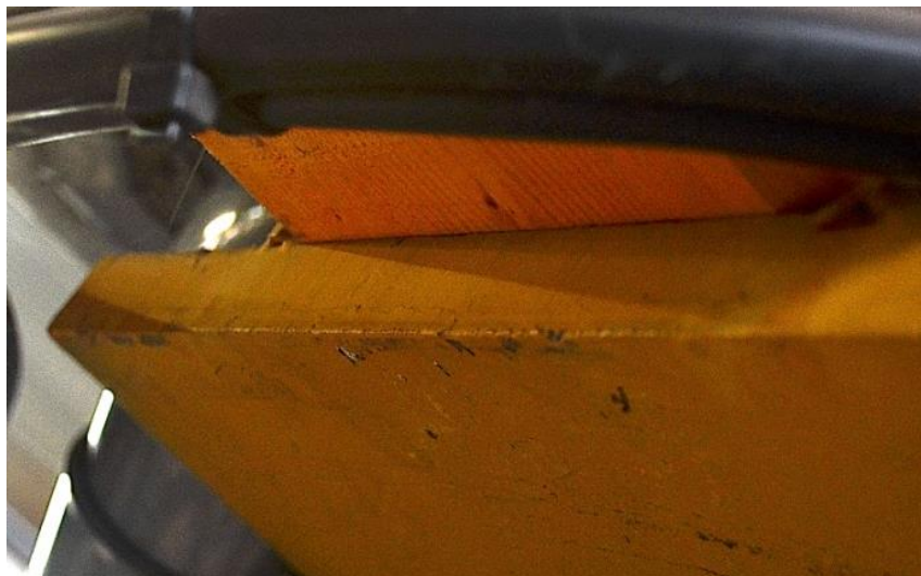
Figure B-133 : Enfoncement de l'appui intermédiaire de l'extension (File E-12)
