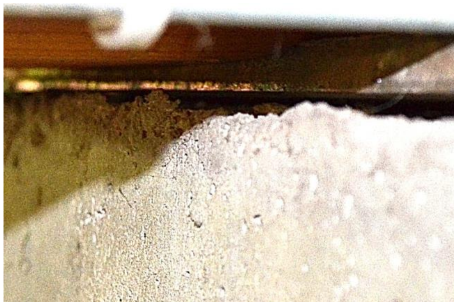
Figure B-131 : Enfoncement de l'appui de rive de la structure initiale
