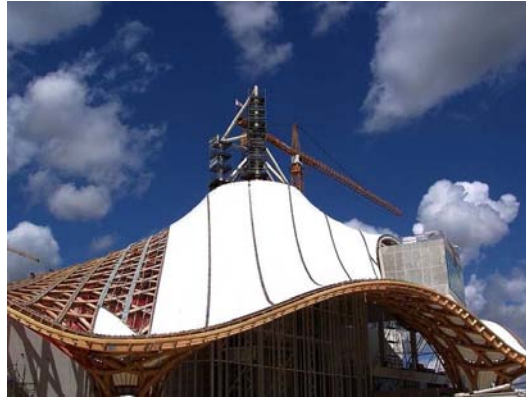
FIGURE 1.1 – Charpente et membrane du toit du Centre Pompidou à Metz pendant sa construction. L'architecture de la toiture est faite en double courbures pour permettre sa résistance face aux aléas climatiques (vent, neige, grêle,...). (source : blog Marc de Metz).
