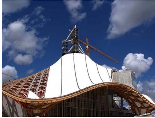
FIGURE 1.1 – Charpente et membrane du toit du Centre Pompidou à Metz pendant sa construction. L'architecture de la toiture est faite en double courbures pour permettre sa résistance face aux aléas climatiques (vent, neige, grêle,...). (source : blog Marc de Metz).
