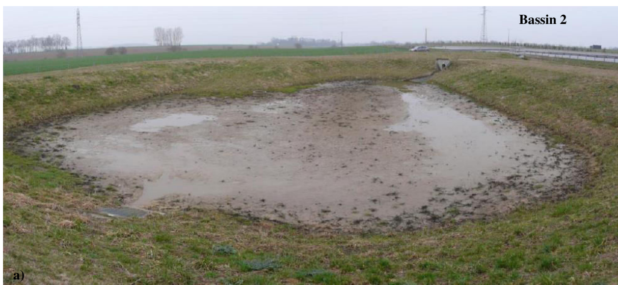
Figure IV.39 : État du bassin de rétention n°2 avant les travaux de réparation.
