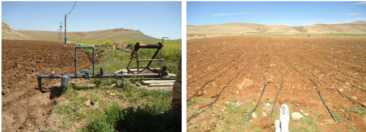
Planche photos 10.6. Equipements de la technique de la goutte à goutte à Guigou
