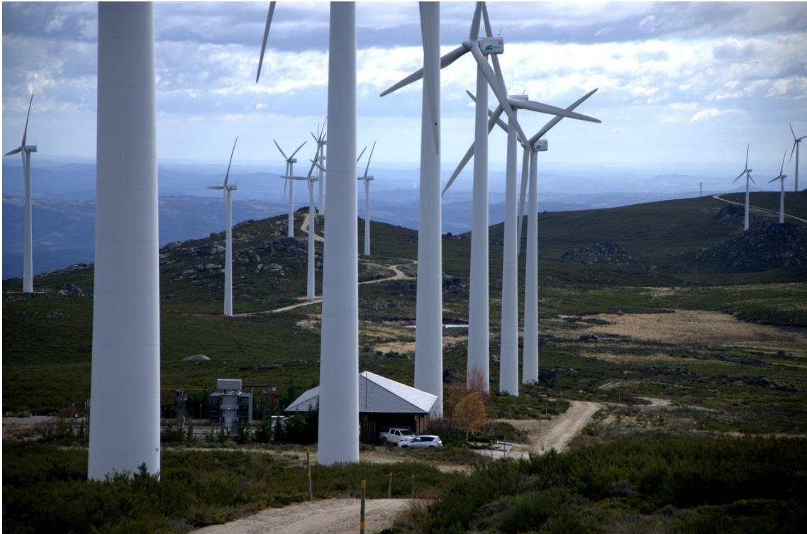
Figura 94. Aerogeneradores y subestación colectora y elevadora del parque eólico Nerea, sitios en el término municipal de Requejo. D. Herrero, 2013.
