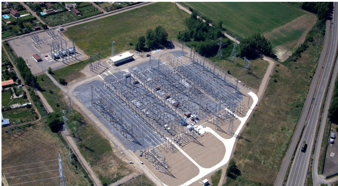
Figura 143. Subestación Grijota. D. Herrero, 2015.
