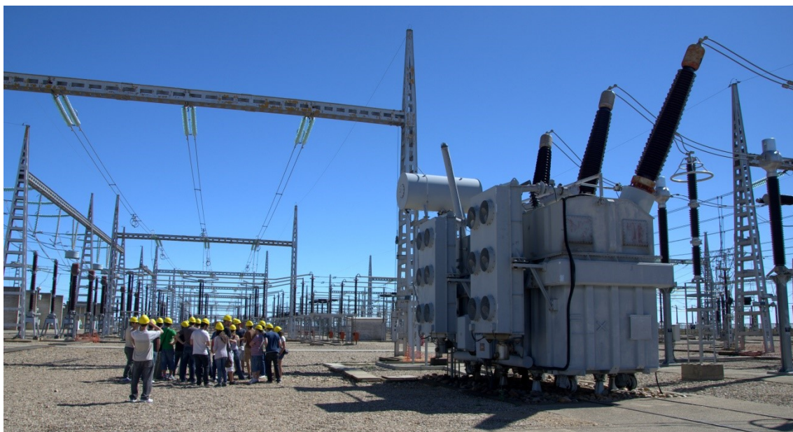
Figura 208. Interior de la Subestación eléctrica de La Mudarra –Valladolid-. D. Herrero, 2012.
