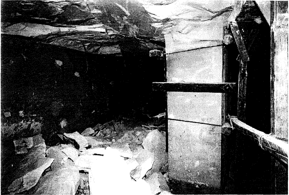
Photo 2-7. Rupture des piliers dans la chambre joutant la chambre funéraire de la tombe de Sèti Ier à Louxor. Ces ruptures mettent en cause la stabilité de la chambre funéraire.
