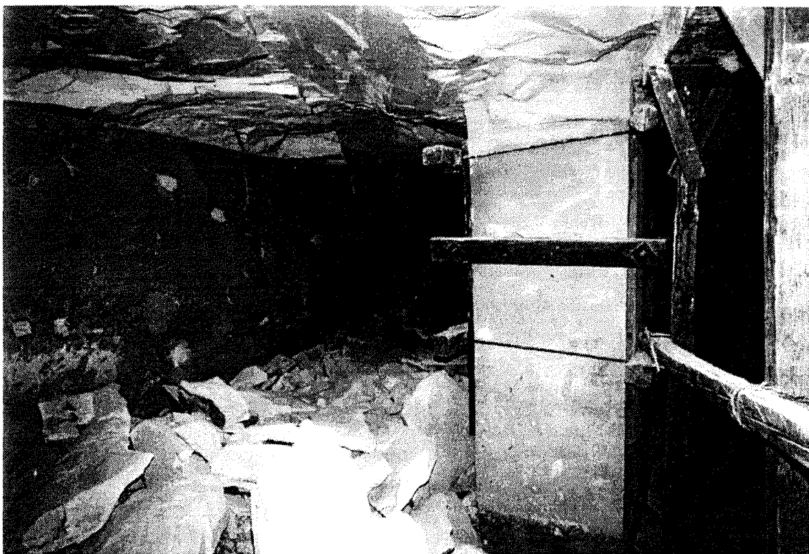
Photo 2-7. Rupture des piliers dans la chambre joutant la chambre funéraire de la tombe de Sési Ier à Louxor. Ces ruptures mettent en cause la stabilité de la chambre funéraire.
