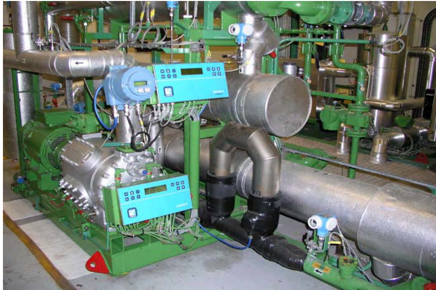
Fig. 3.72. Instalația frigorifică EDF – HP410A.
