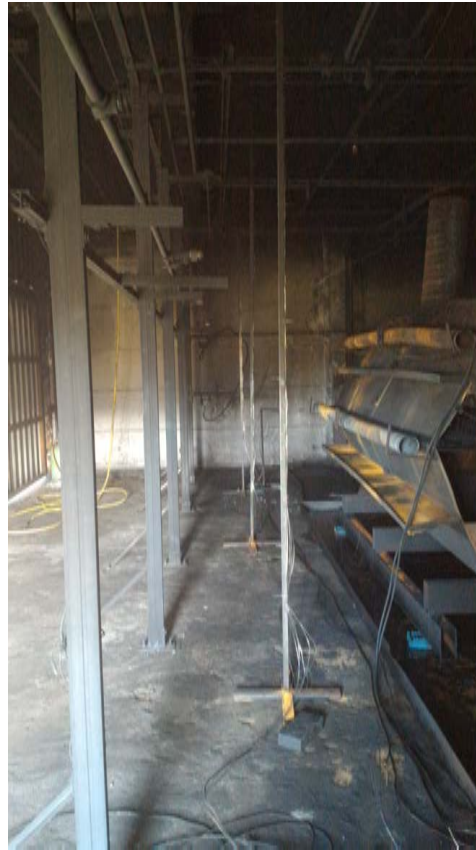
FIGURE 2.2 – Maquette de transformateur et banc de brouillard d'eau présents dans le local d'essais.
