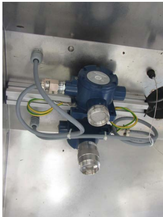
FIGURE 4.32 – Détecteurs de gaz placés dans la hotte.
