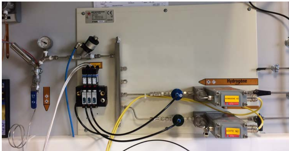
FIGURE 4.26 – Photo de l'installation d'arrivée de gaz.
