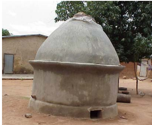
Figure 2 : Enduit ciment sur le corps du grenier [13]
