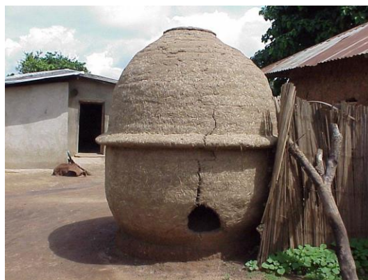
Figure 3 : grenier en terre tombé en ruine
