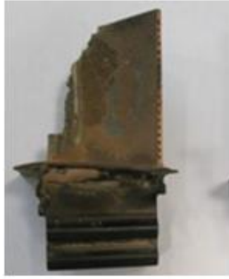
Figure 1-7 : Aube de turbine HP ayant fondu du fait du bouchage des trous de refroidissement [Duf17]
