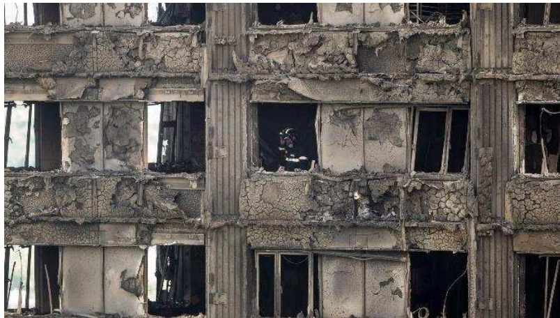
Figure 4.1. Dégâts causés sur la façade de la tour Grenfell à Londres par l'incendie.
