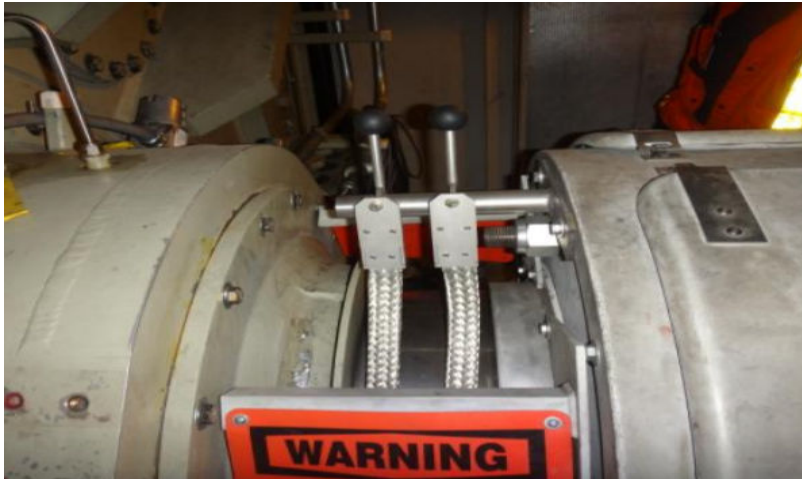
FIGURE 1.3.10 – Exemple de mesures de tension de palier : balais de type tresse utilisé pour le monitoring de la tension de palier, Stone et al. (2014)
