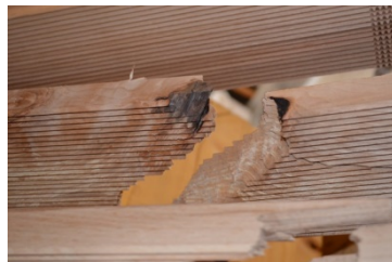
Rupture de la poutre treillis au niveau d'un nœud.
