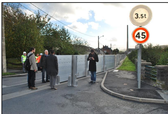
PHOTO 1 – EXEMPLE DE MESURE STRUCTURELLE : BARRAGE MOBILE CONTRE LES CRUES À GIVET, ARDENNES (EPAMA 2013)
