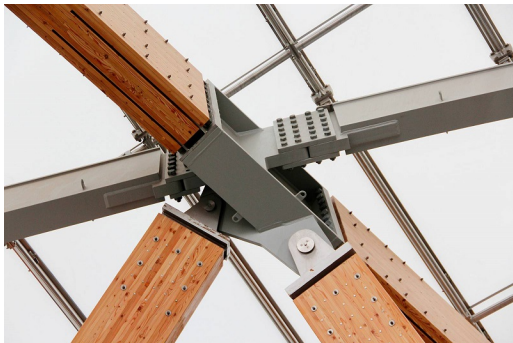
Fig. 1.2 Assemblage de la structure des verrières de la Fondation Louis Vuitton (© Bureau Greisch, www.greisch.com ).
