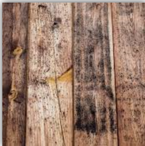
Figure 15: Moisissures sur le bois
