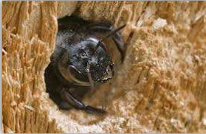
Figure 21: Abeille charpentière dévorant le bois
