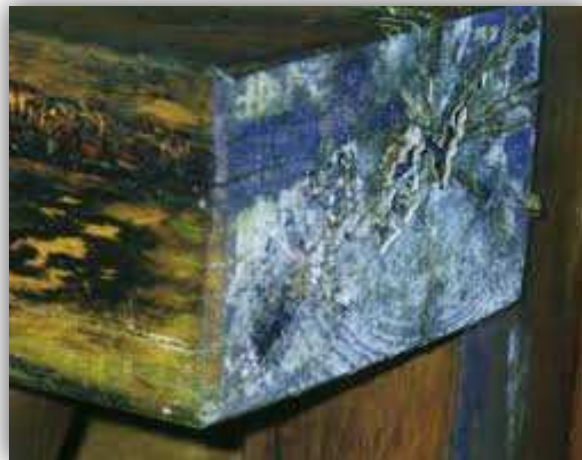
Figure 16: Coloration bleu/gris sur le bois de charpente due à la présence d'agents de bleuissement
