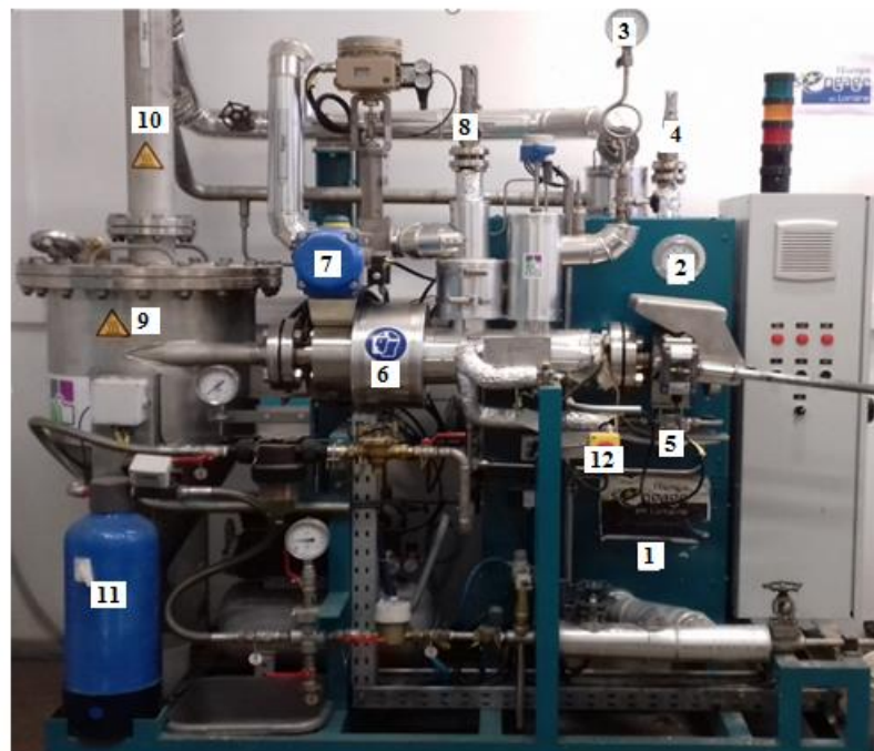
Figure 27: Installation pilote de l'explosion à la vapeur.
