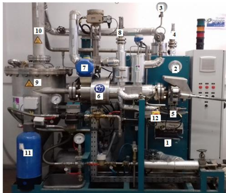
Figure 27: Installation pilote de l'explosion à la vapeur.
