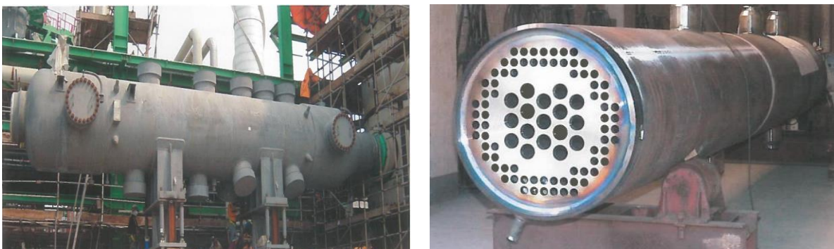
Figure I - 3. Exemple de WHB : installé sur site (à gauche) et arrangement spatial interne des tubes (à droite). (Brochure Process Gas Cooler Alstom).
