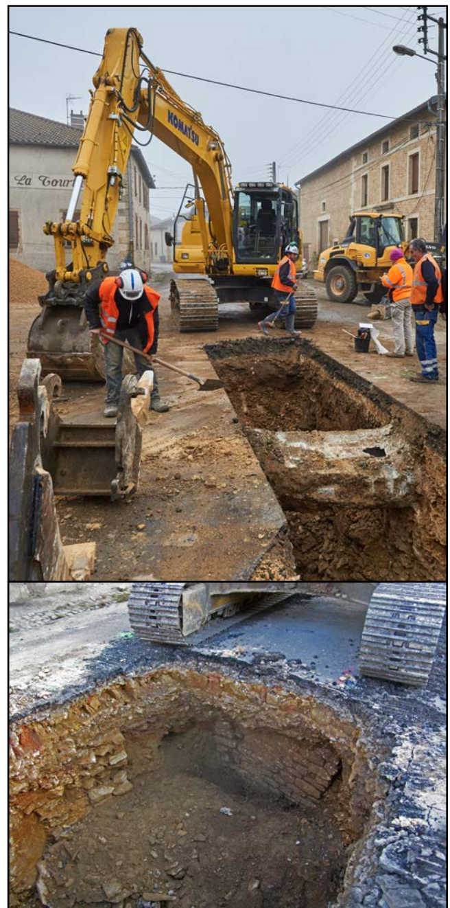
Figure 41 : vues du suivi des travaux d'assainissement de Senon en 2016 (clichés : J.-C. Szuka)
