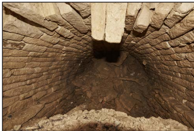
Figure 196 : vue intérieure de l'aqueduc souterrain dans la rue de Fournirue (cliché : INRAP GE)
