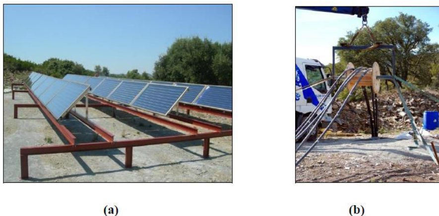
Figure 1. 16 : Installation expérimentale de : (a) champs des panneaux solaire, (b) sondes géothermiques (Delaleux et al. 2012).
