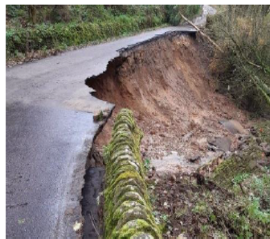
Glissement de terrain
