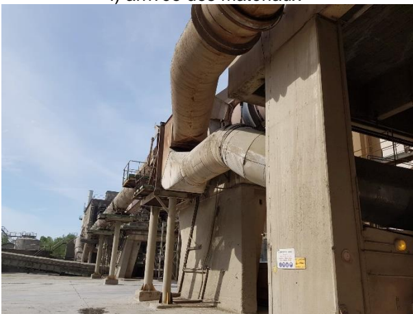
III) conduits d'acheminement des gaz du four vers le sécheur à cru
