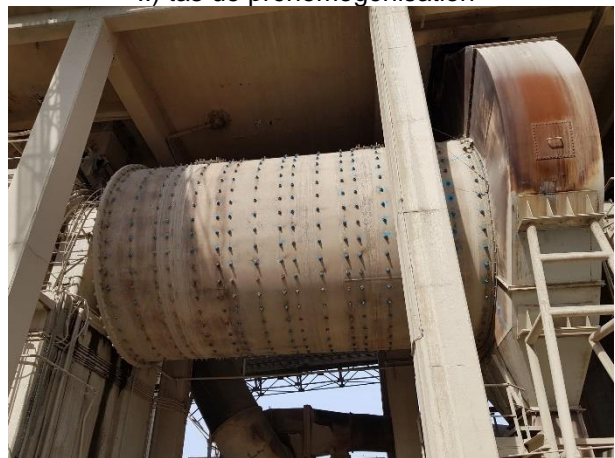
IV) broyeur à boulets (Polysius®) pour le cru avec son séparateur dynamique (à droite sur la photo)
