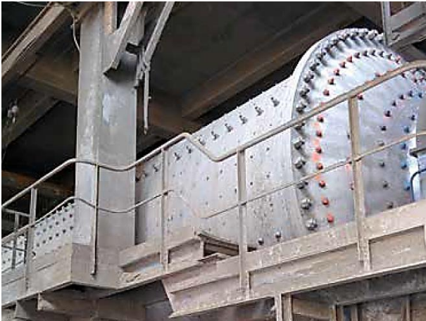
I) broyeur à boulets (Cimenterie de Créchy)
