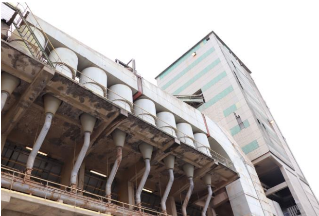
I) Tunnel de préchauffage
