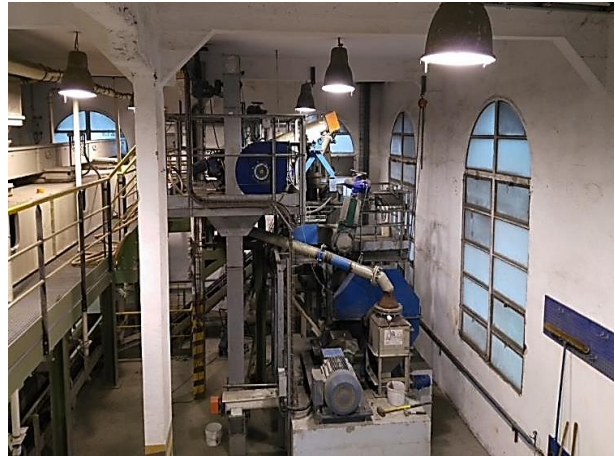
II) broyeur à boulets (Plateforme R&D)
