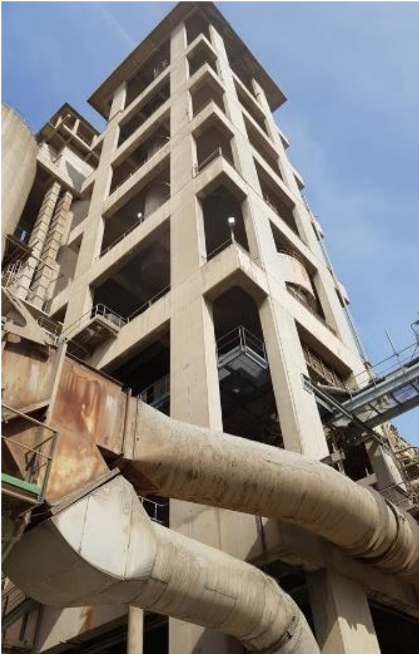
I) tour de préchauffage
