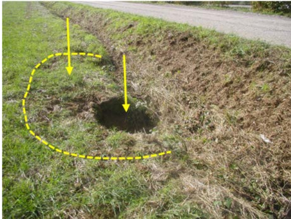
Photo 7.9 – Doline d’effondrement de type subsidence sinkhole dropout de 1 m de diamètre et de profondeur observée à Ancerville en octobre 2019 (cliché : Goutorbe – GERSM, 2019)
