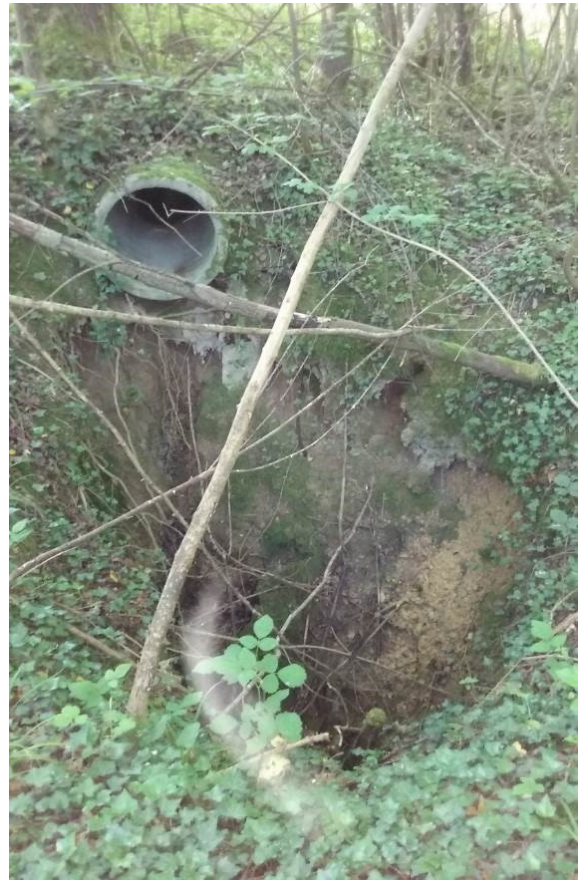
Photo 7.22 – Gouffre-perte (n° 2726) alimenté par le tuyau d'évacuation des eaux de ruissellement de la RN4 (Ancerville) (cliché : Bensaadi, 2018)
