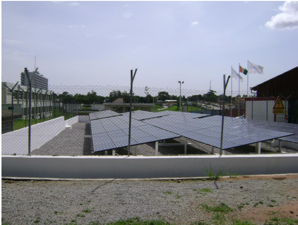
Photo 17 : Vue des panneaux solaires au sol sur le campus FHB de Cocody
