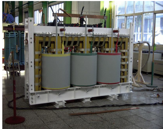
(b) Transformateur [WAN07]
