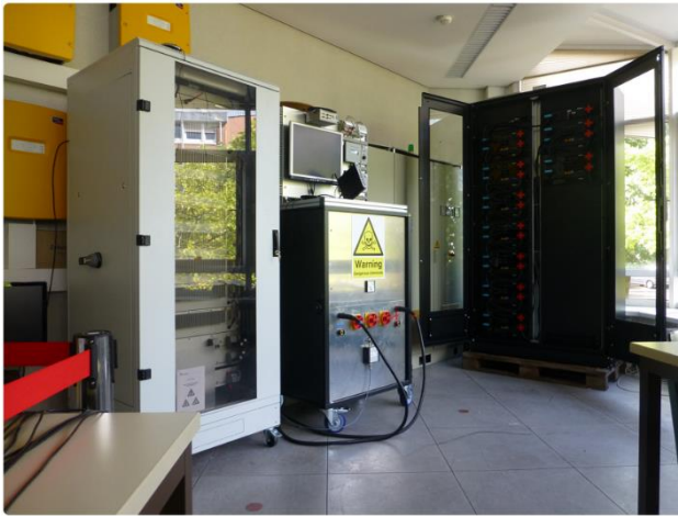
fig. 157 plateforme équipée de batteries lithium-ion
