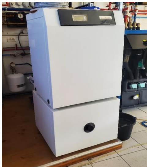
fig. 166 : Pompe à chaleur
