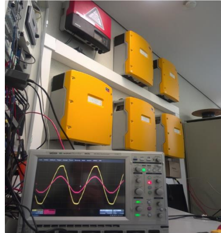
fig. 158 Convertisseur de réseau et onduleurs pour batterie
