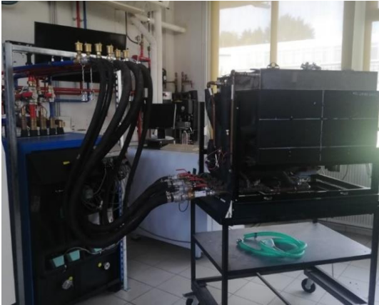
fig. 108 Machine à Adsorption Sortech à la plateforme ENERBAT
