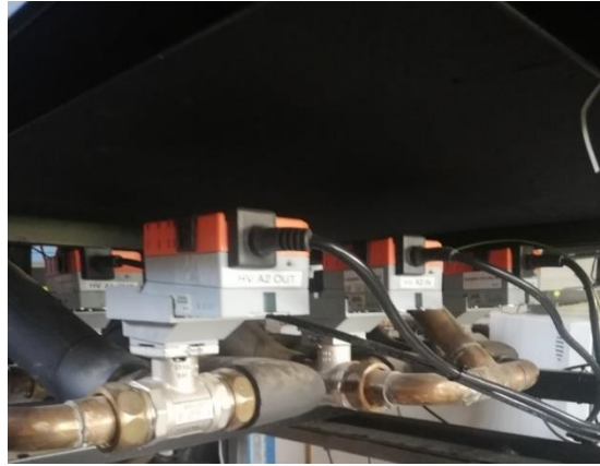
fig. 107 Vanne HV 3 voies du circuit hydraulique extérieur de la Machine à Adsorption Sortech
