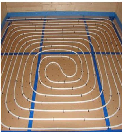
fig. 170 Système de chauffage au sol de la cellule biclimatique
