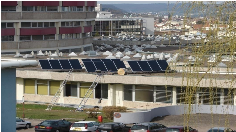
fig. 167 : champ solaire de la plateforme ENERBAT
