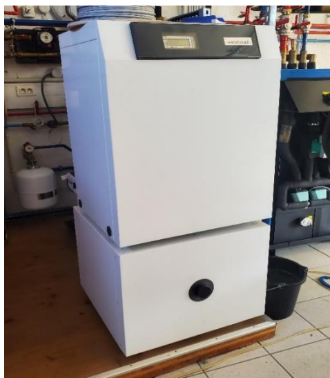
fig. 166 : Pompe à chaleur
