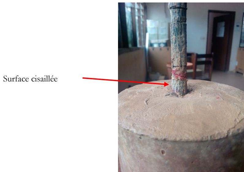
Photo 4-11 : Glissement de l'armature du bloc de béton de latérite
