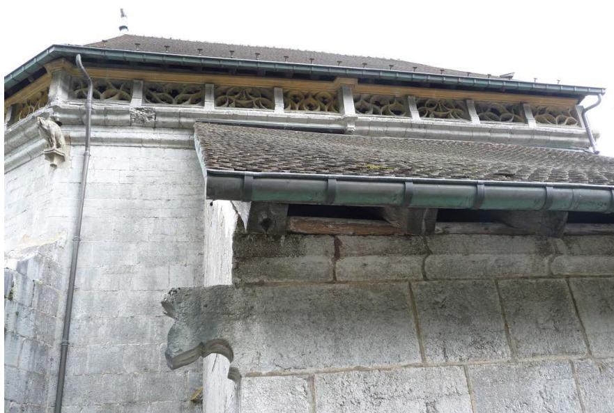
Cat. n° 8/5 - vue extérieure du chœur, côté nord (cliché de Nicolas Boffy)
