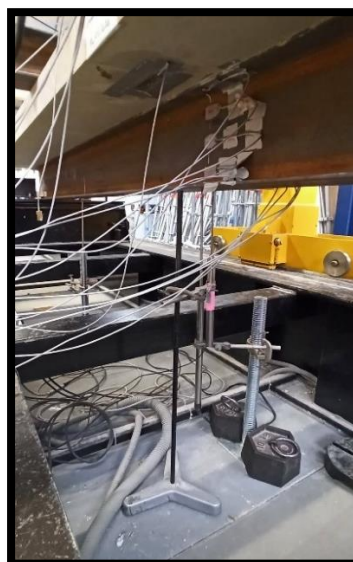
(c) Capteurs LVDT à mi-travée.
