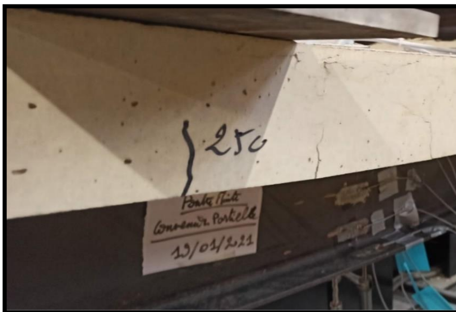
Figure 5.31 Initiation des fissures sur la face inférieure de la dalle de béton de ‘PM-CP’.
